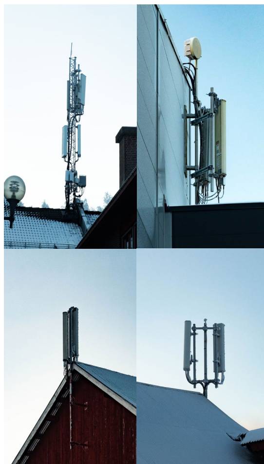
Basestasjoner kan se litt forskjellige ut.
